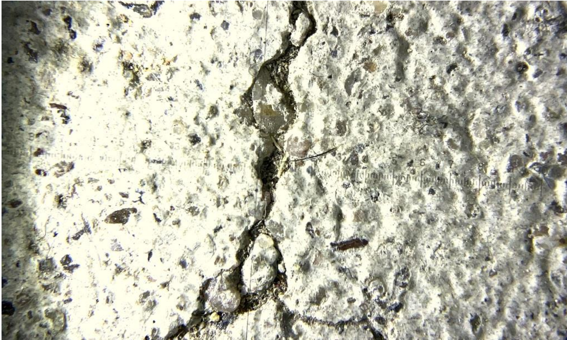
Rissbetrachtung mit Risslupe
