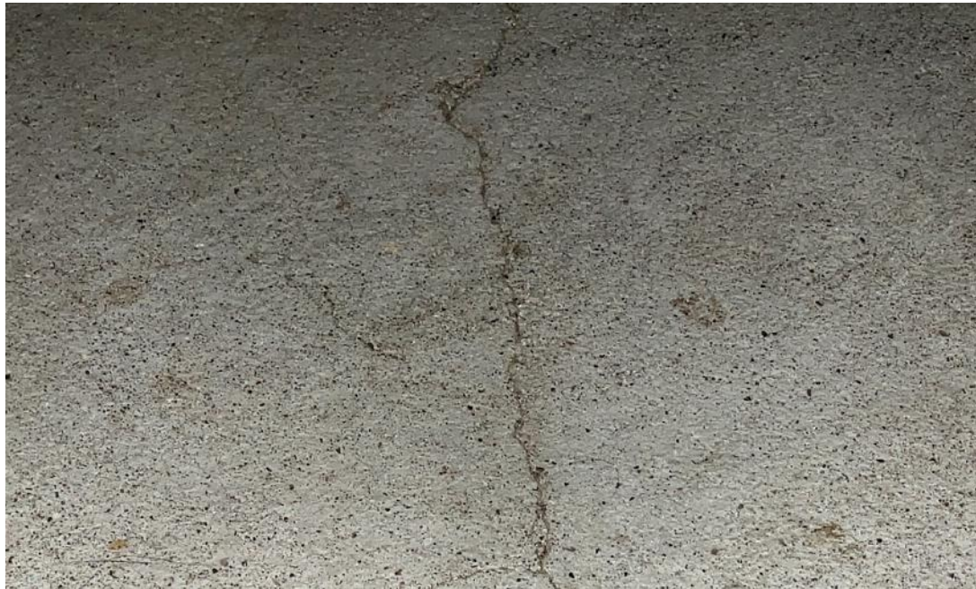
vorhandener Riss im Estrich
